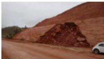
Figura 1 – Talude em análise após a ocorrência de ruptura em julho de 2015. Fonte: Adaptado de Arêdes & Merlo (2016).
