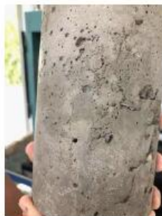
Figura 2 - Fissuras após rompimento
