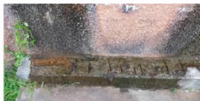
Figura 1.b – Fissuras, falta de cobrimento da ferragem e bolor.
